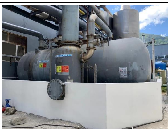
泵房南侧缓冲罐 (中间罐)
