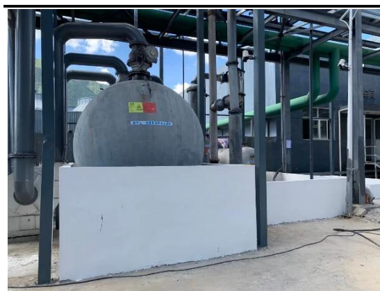
循环水池南侧缓冲罐 1 (中间罐) 循环水池南侧缓冲罐 2 (中间罐)
