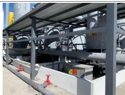
尾气处理区油喷淋、电捕焦油器围堰
