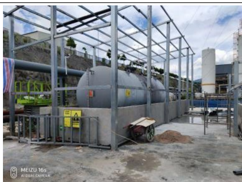
尾气处理区危废储存罐、中间缓冲罐围堰
